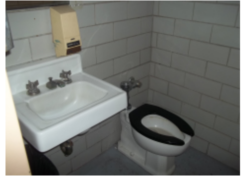
Non ADA Compliant Toilet
